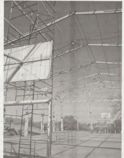
APÓS troca de telhas, rede elétrica precisará ser refeita
