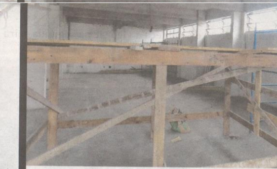
Obra da Biblioteca está abandonada
