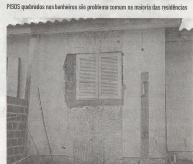
PORTAS e janelas apodreceram rapidamente e até pedaços de parede já caíram
