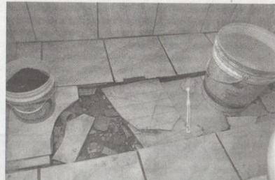
PISOS quebrados nos banheiros são problema comum na maioria das residências
