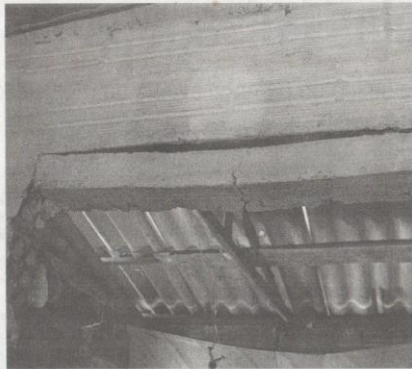
APARENTEMENTE, a quantidade de ferro usado nas vigas não foi suficiente
