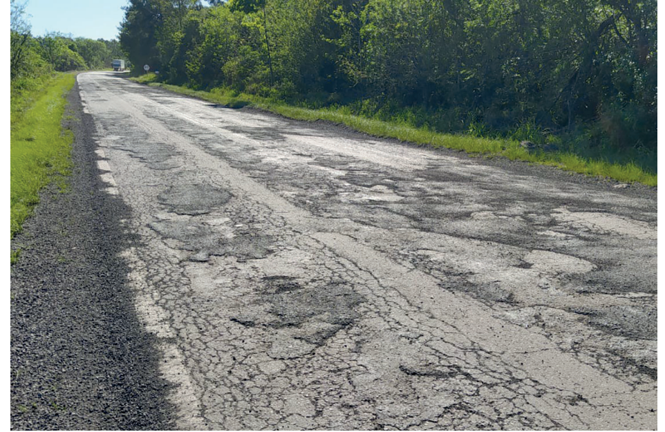
Trecho do Muda Boi está em piores condições
