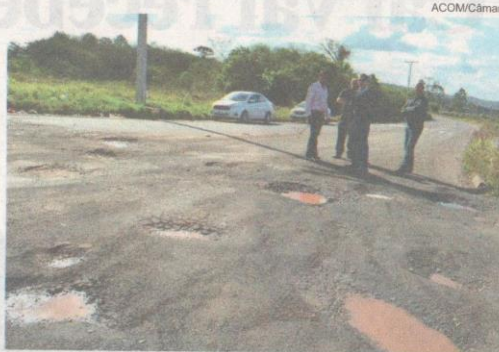
Falta trevo de acesso e acostamento está todo esburacado
