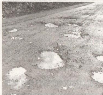
PELO INTERIOR, leitores como o Diego Kossman enviaram registros do estado precário em que se encontram as estradas
